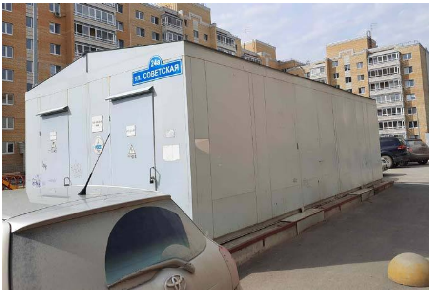
Трансформаторная подстанция 2КТП(К)-2000/10/0,4
