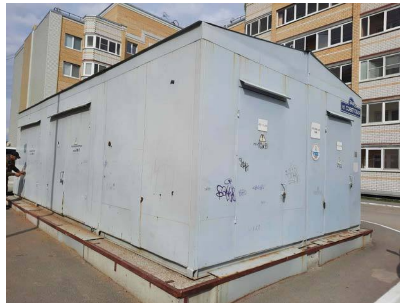
Трансформаторная подстанция 2КТП(К)-2000/10/0,4
