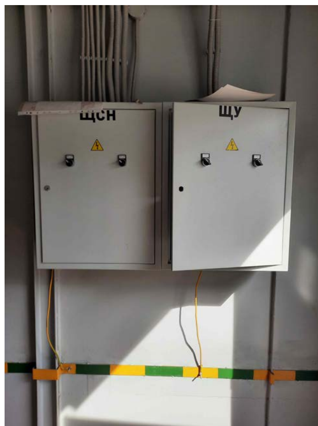
ЩУ (щит учета) ЩСН (щит собственных нужд)
