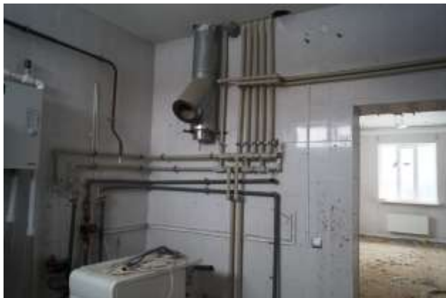
фотография №16 Котельная (№5 на поэтажном плане 1-го этажа)
