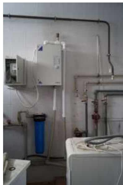
фотография №18 Котельная (№5 на поэтажном плане 1-го этажа)
