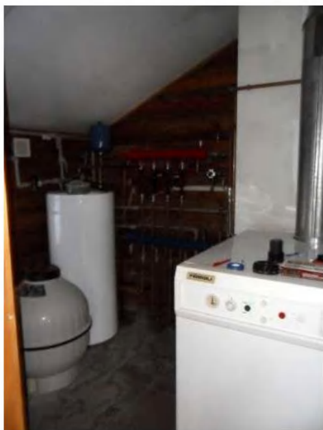
ФОТОГРАФИЯ 11. КОТЕЛЬНАЯ, ПОМЕЩЕНИЕ 10 ПО ПЛАНУ БТИ (ВИД 1)
