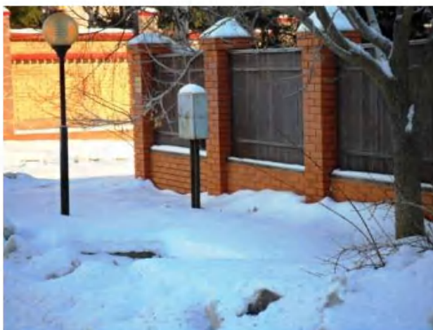
ФОТОГРАФИЯ 27. ЭЛЕКТРИЧЕСКИЙ ЩИТОК
