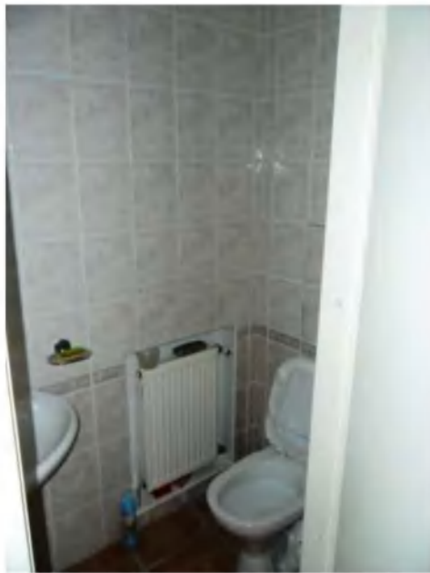
ФОТОГРАФИЯ 31. Санузел. Помещение 19 по плану БТИ (вид 2) ЭЛЕМЕНТ ПЕРЕОБОРУДОВАНИЯ И ПЕРЕПЛАНИРОВКИ
