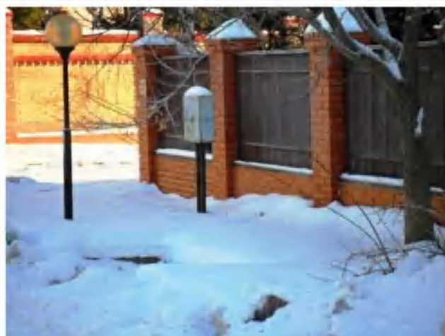
ФОТОГРАФИЯ 45. Электрический щиток
