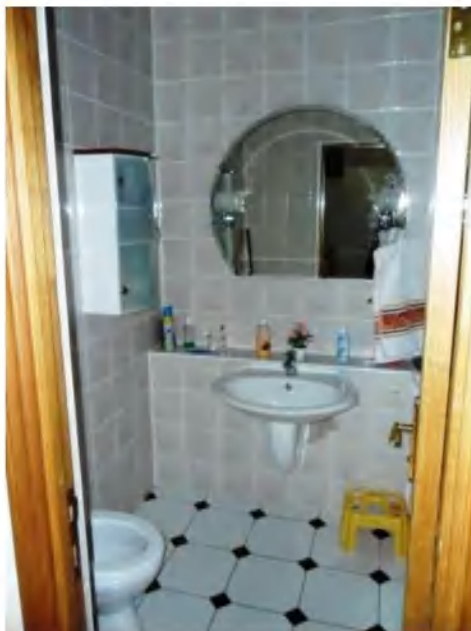
ФОТОГРАФИЯ 5. САНУЗЕЛ. ПОМЕЩЕНИЕ 2 ПО ПЛАНУ БТИ ЭЛЕМЕНТ ПЕРЕОБОРУДОВАНИЯ И ПЕРЕПЛАНИРОВКИ
