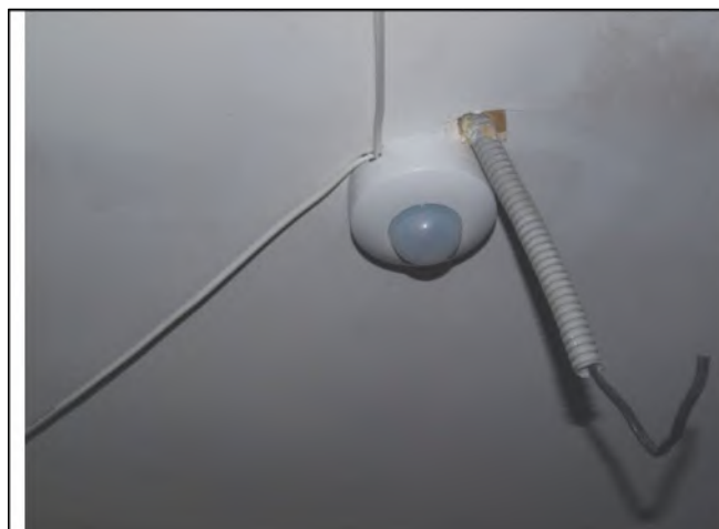
Здание спального корпуса площадью 596 кв. – пожарная сигнализация, провод электроснабжения
