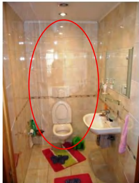
Фотография 16. Сан. узел. Помещение 7 по плану БТИ ЭЛЕМЕНТЫ ПЕРЕОБОРУДОВАНИЯ И ПЕРЕПЛАНИРОВКИ
