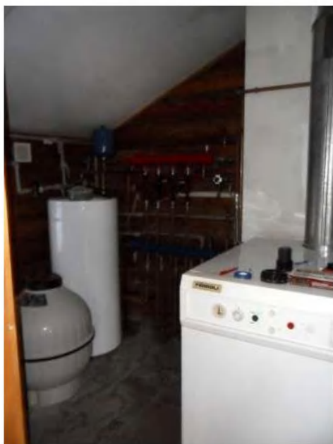
ФОТОГРАФИЯ 11. КОТЕЛЬНАЯ, ПОМЕЩЕНИЕ 10 ПО ПЛАНУ БТИ (ВИД 1)
